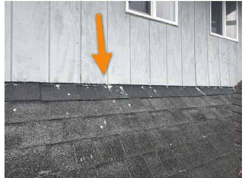
No apron flashing
